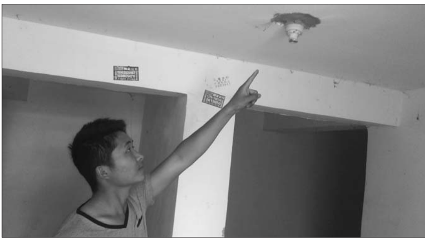
楼道的照明灯泡已经丢失。本报记者 苏洪印 摄
