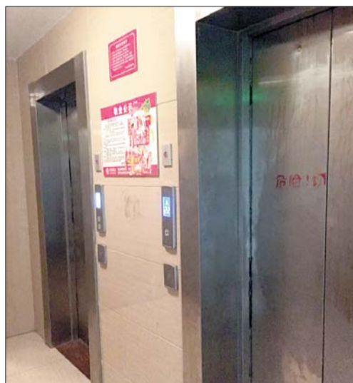
电梯频出故障 地下室渗水发霉
