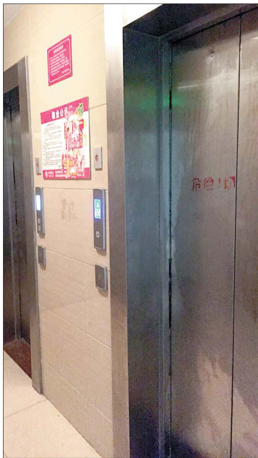
时常发生故障的电梯。
