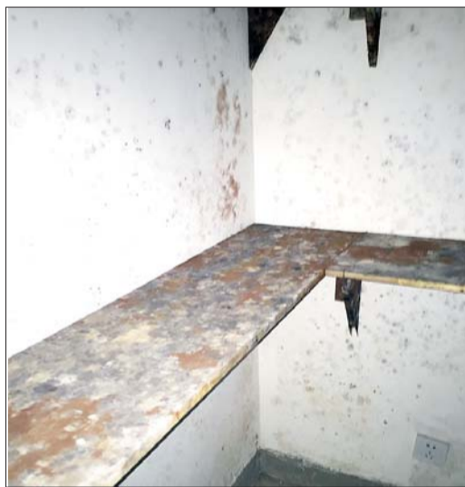
墙面不仅发霉,储物架木板上还有很多霉菌。
