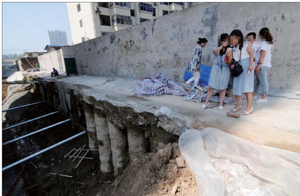
菏泽牡丹区检察院家属院外墙东侧下沉。
