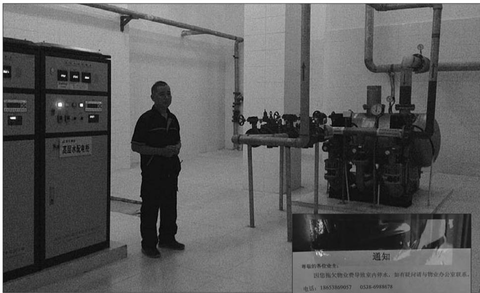
大图:新城国际小区内二次加压泵房。 小图:物业贴在业主门口的停水通知。
