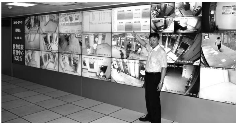
工行工作人员向记者展示“报警监控综合管理”系统。
