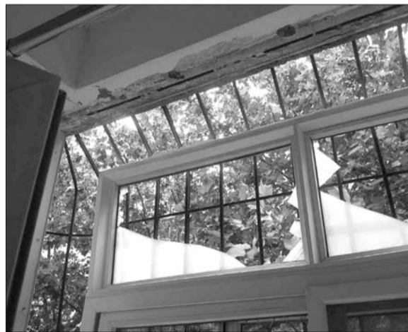
窗玻璃被震碎,铝合金窗框也脱落下来。 本报见习记者 王建伟 摄
