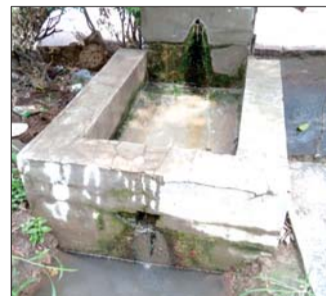
不断往外漏水的水阀。
