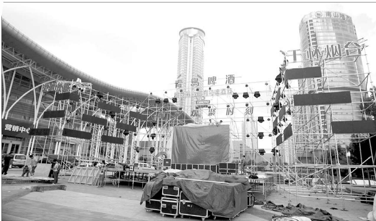
22日下午,工作人员正在搭建啤酒节舞台。本报记者 赵金阳 摄
