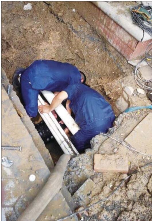
泰山名郡小区广场西南角是此次管线的爆裂点。
