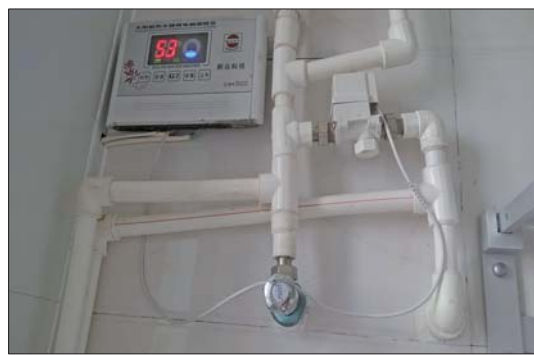
沈女士家卫生间墙上的太阳能测控仪屏幕上一直显示着“低水压”。
