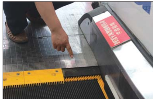
扶梯的梳齿板缺失。本报记者 高雯 摄
