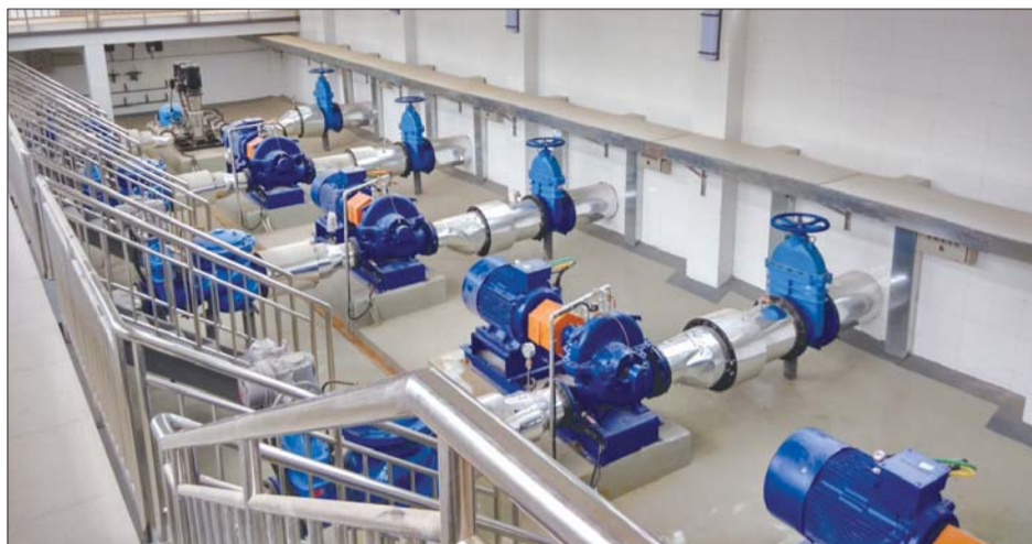
龙洞北加压站今年新修了蓄水池,正源源不断向周围片区供水。
