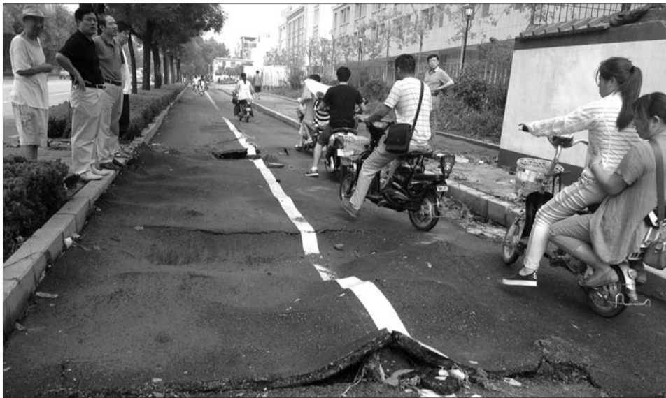
人行道沥青被顶开。本报记者 王世腾 摄
