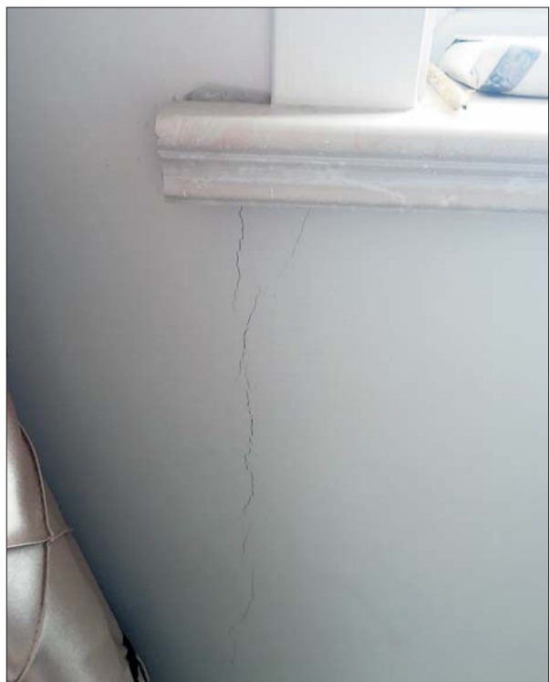
墙体裂缝从窗台延伸到地上。记者 邢敏 摄
