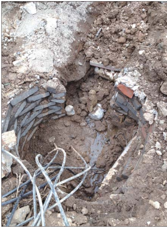
化工厂被挖断的排污管仍有污水在往外漏。本报记者戚云雷摄
