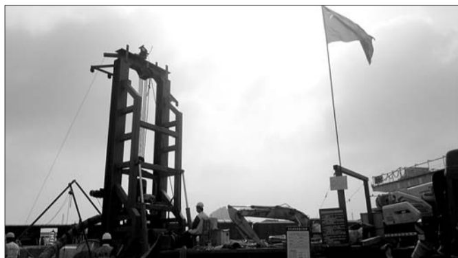
丹阳路跨铁路立交桥西侧主塔正式开工。本报记者 张建丽 摄
