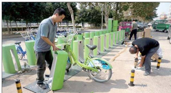
金盾花园站点正在进行车桩扩容。 通讯员 杜贵君 摄
