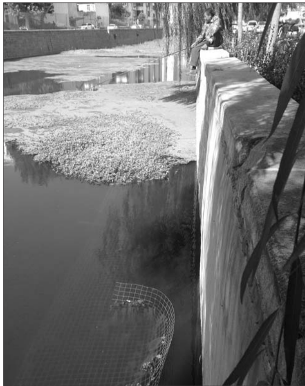
护栏被破坏的地方,仍有市民在垂钓。本报记者 赵兴超 摄。
