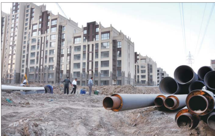
淄博高新区中润大道附近一新建小区已列入淄博高新区供热管网计划。本报记者 王鸿哲 摄
