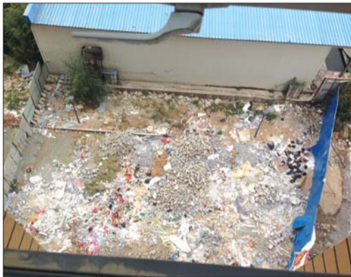
建筑垃圾被围挡拦住。 本报记者 陈新 摄
