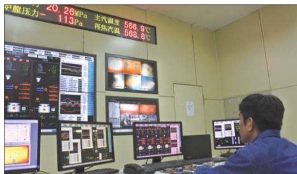
黄台电厂的热源已经出厂,工作人员正在调度。
