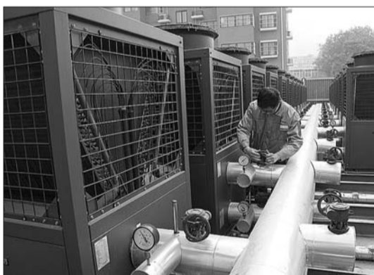
位于方正园小区的空气源热泵。本报记者 蒋龙龙 摄
