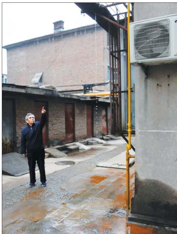
市公安局二宿舍外一供暖管道出现漏水。 本报记者 王鸿哲 摄
