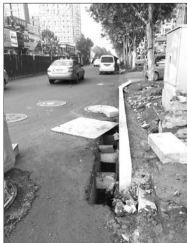
化纤厂路一处下水口,施工后留下不小的孔洞。 本报记者 王杰 摄
