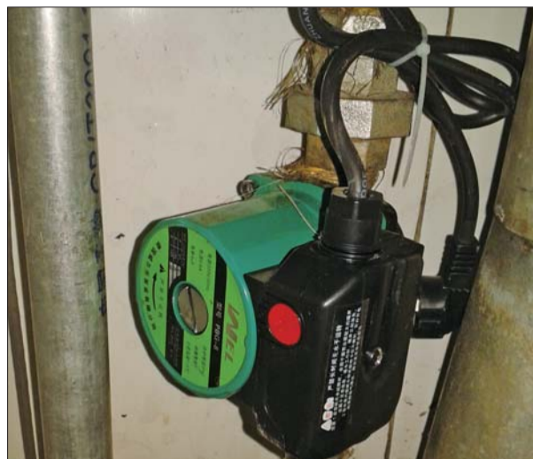
由于家里不热城区一些业主安装了增压泵。
