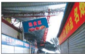
24日,西关农贸市场的顶棚坍塌。本报记者 高祥 摄
