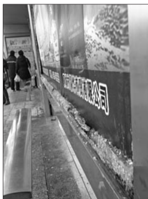
损坏的公交站点广告牌。 本报记者 焦守广 摄
