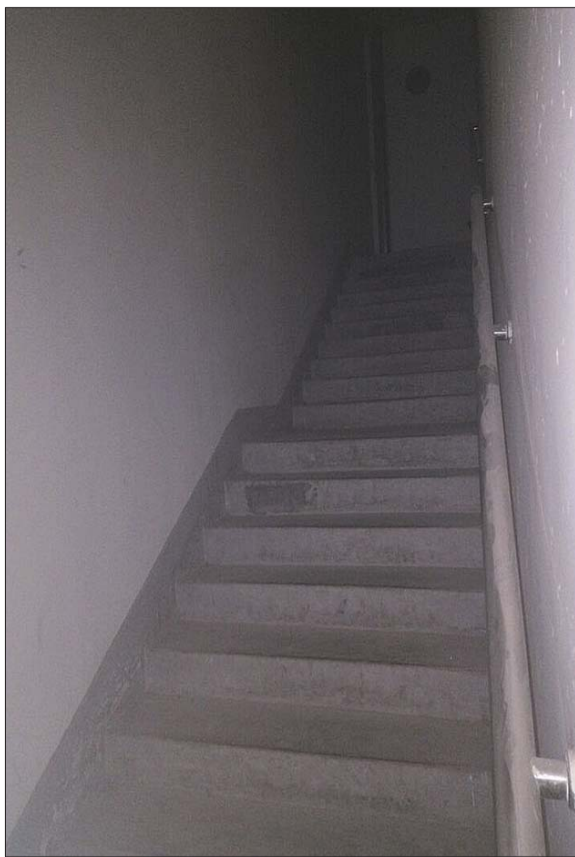
记者用手机闪光灯拍的楼道照片。下午2点就这么黑。见习记者 张永宽 摄
