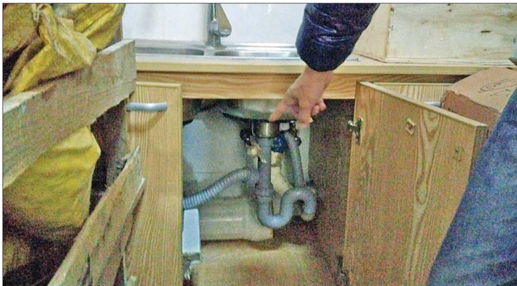
王先生向记者展示厨房里泄漏污水的管道。
