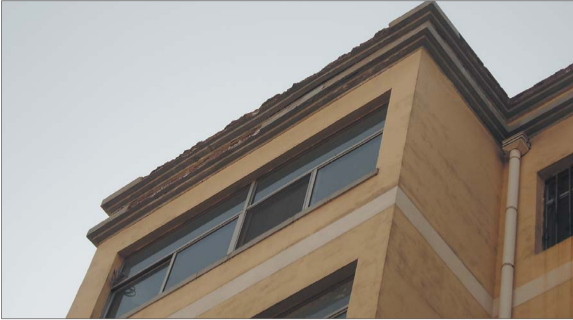
雅居园六区30号楼房檐风化脱落严重。 本报记者 张健 摄
