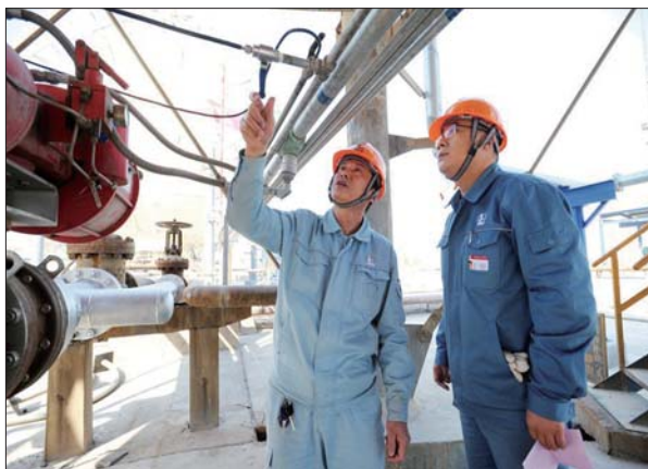
齐鲁石化烯烃厂油品液态储罐隐患项目治理完成,系统安全系数、储存能力有了质的提高。(资料片)
