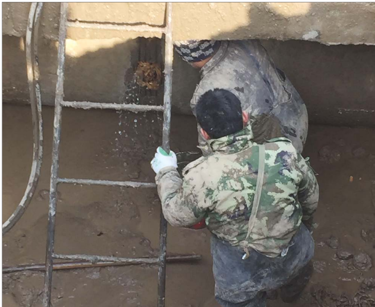
7日中午,水务集团抢修人员正在维修供水管道,此时工作人员已经连续忙了27个小时。 本报记者 张召旭 摄
