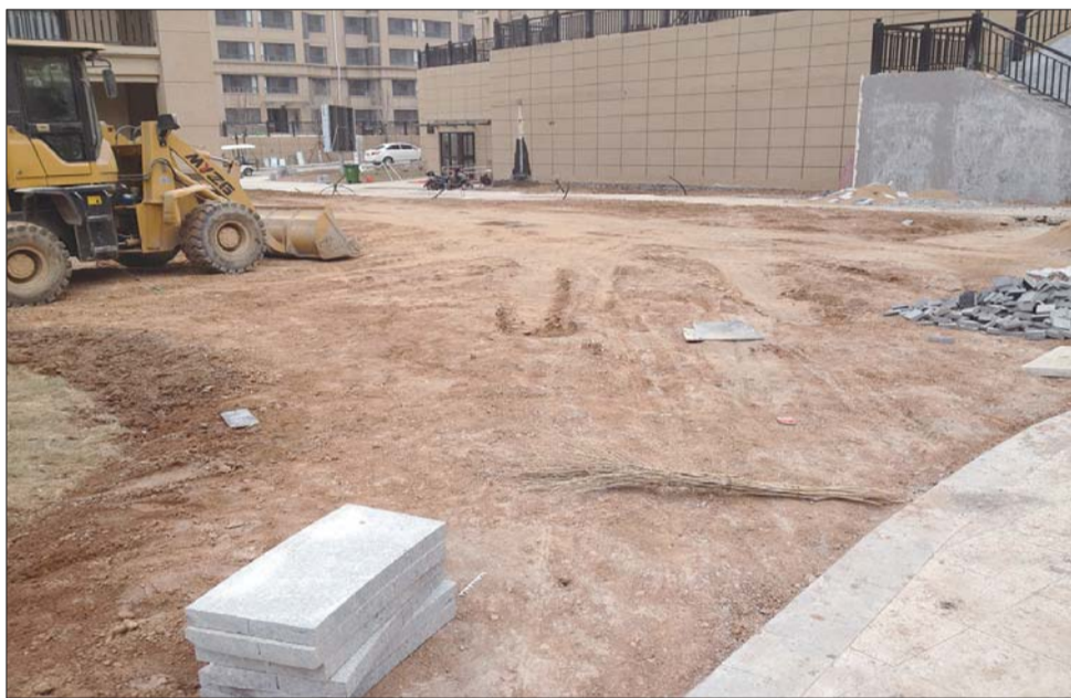
银丰唐郡桂花园公共区域仍在施工,还未取得综合验收备案证明,就让业主办理交房手续。
