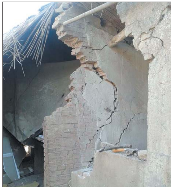
被爆炸震裂的墙面 本报记者 戚云雷 实习生 杨庆宇 摄
