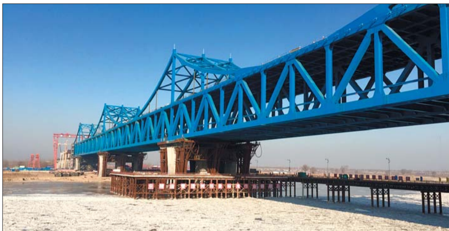
济齐黄河公铁两用桥顶推完成。本报记者 宋磊 通讯员 杨继纲 摄
