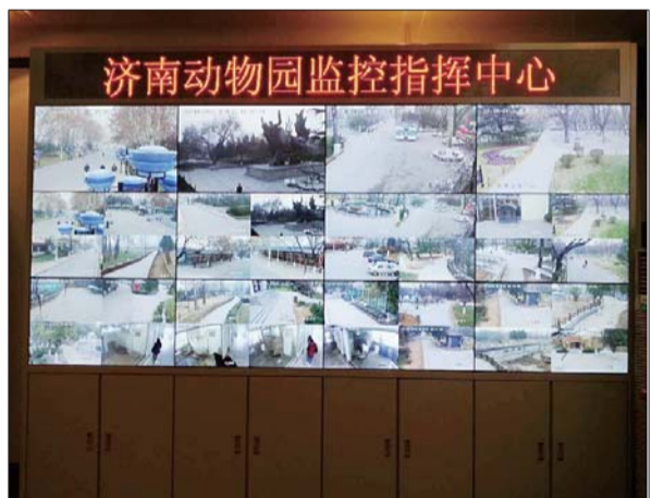
园区监控系统。
