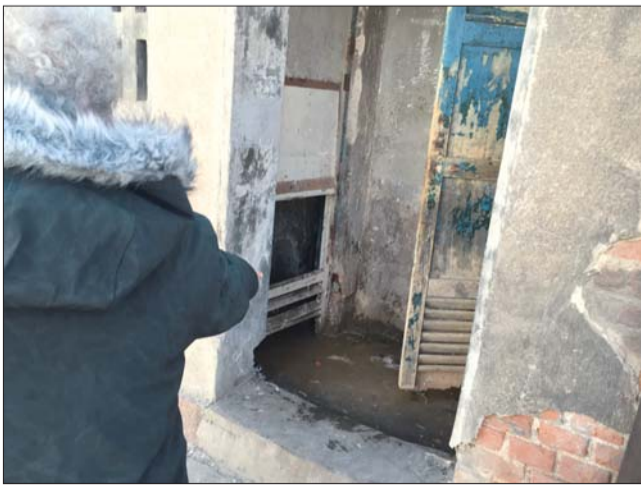
小区只有公共旱厕,污水横流。
