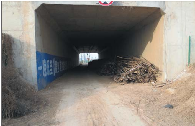
高速路桥下杂物随意堆放,亟需整治。
