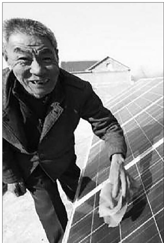
泗水老农在自家房顶上安装了光伏系统,并网发电后躺着也能挣钱。(资料片)
