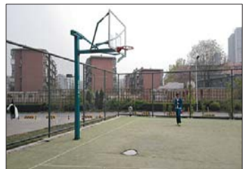
路劲御景城篮球场场地破损两年都没修好。 本报记者 刘雅菲 摄
