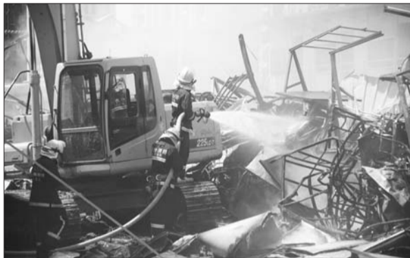
消防战士朝坍塌的板房喷水防患。 本报记者 赵金阳 摄
