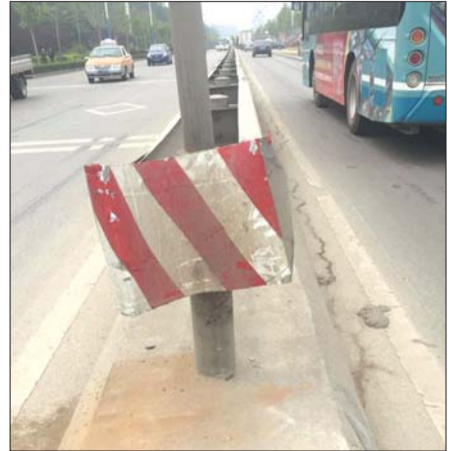
事故现场隔离护栏被撞歪。
