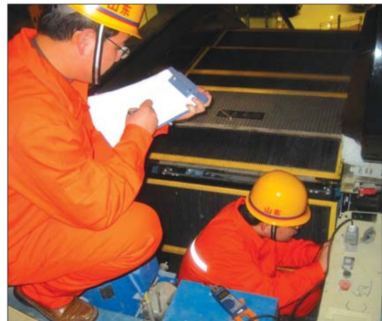
检修盖板、防护挡板。
