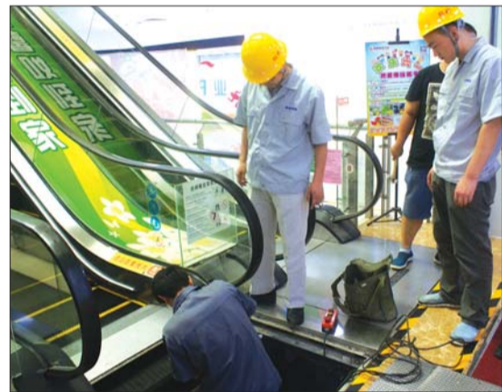
检修盖板、防护挡板。
