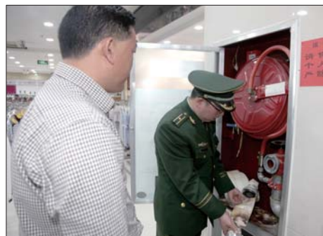
消防监督人员检查超市的一处消防栓。本报记者 苏洪印 摄
