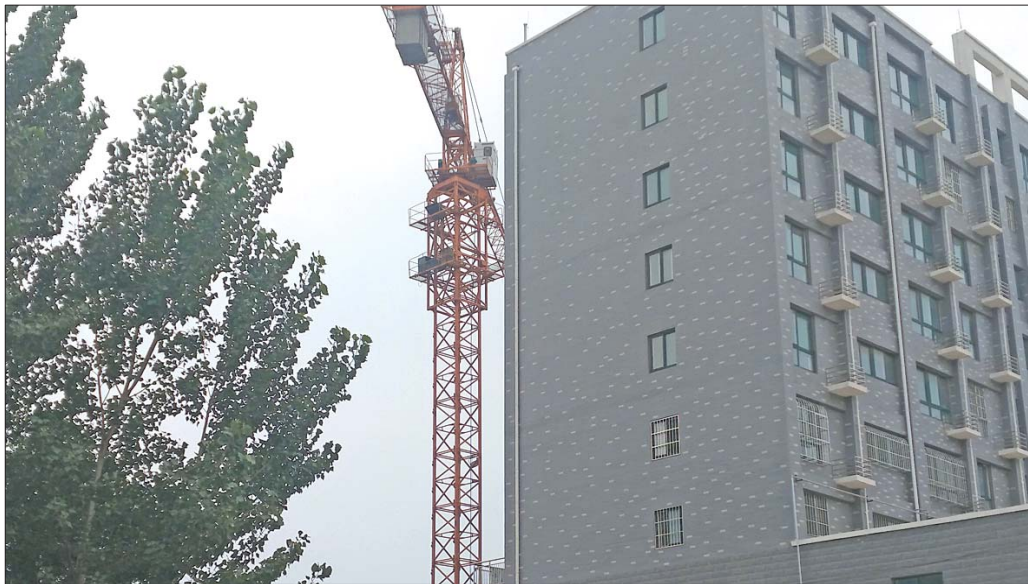
塔吊一直竖在小区内,对来往居民带来了安全隐患。
