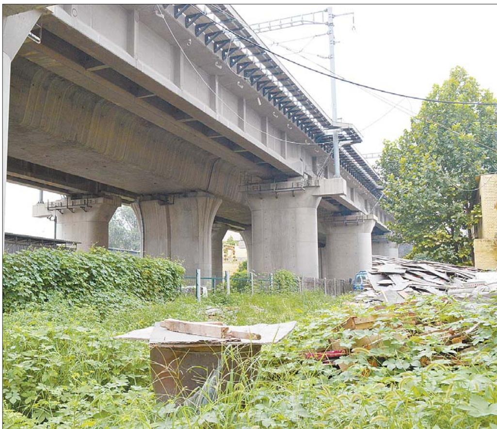
党杨路旁铁路桥下堆积的木板。
