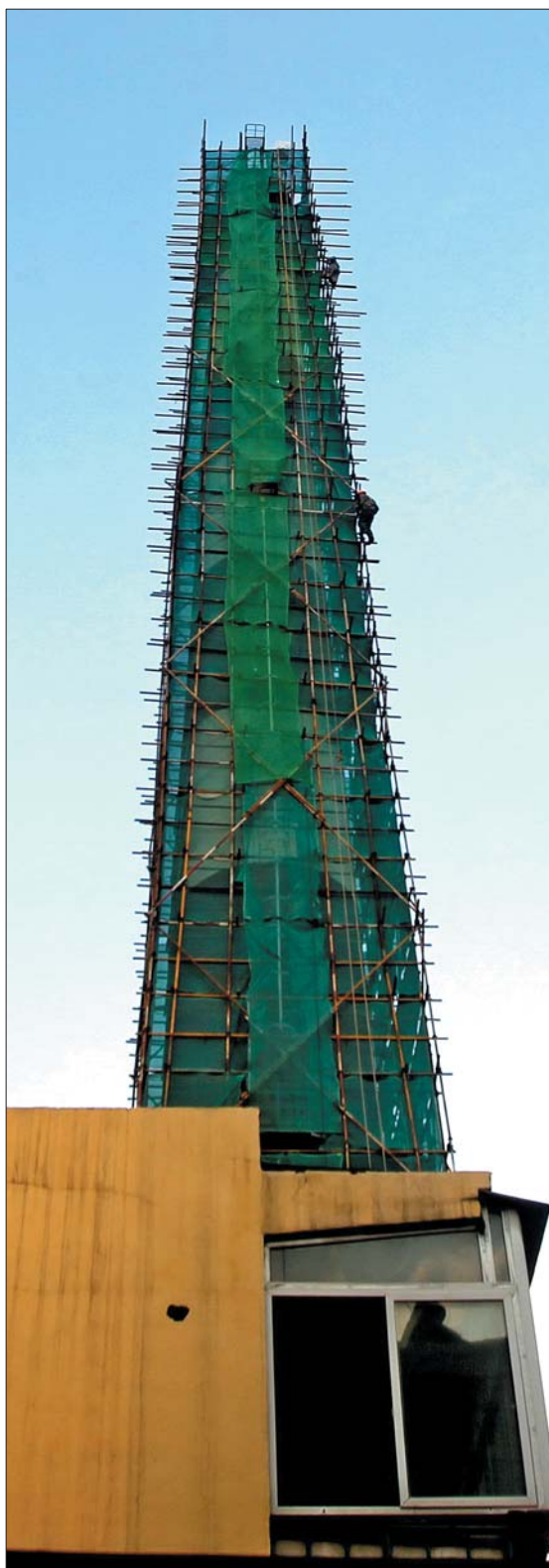
7月23日,脚手架搭建完成。工人们爬上爬下,高空作业即便有安全带,一般人也无法承受登高的恐惧。
