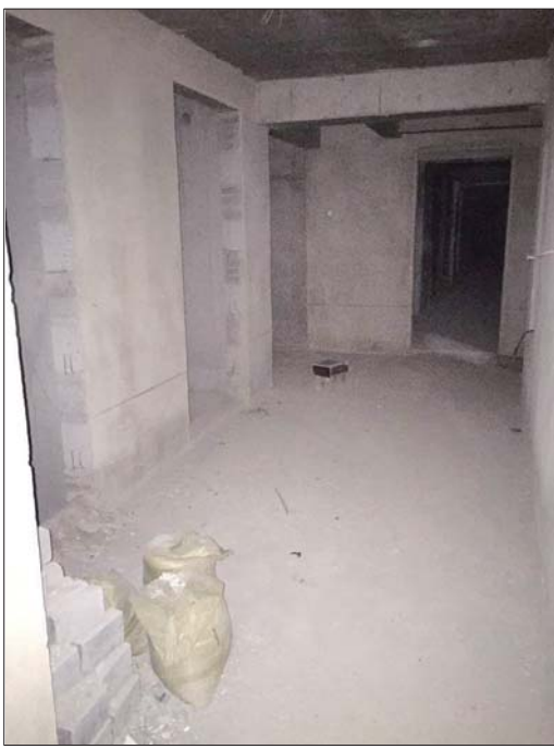
楼内光线昏暗, 电梯井和楼内出口相隔很近。
