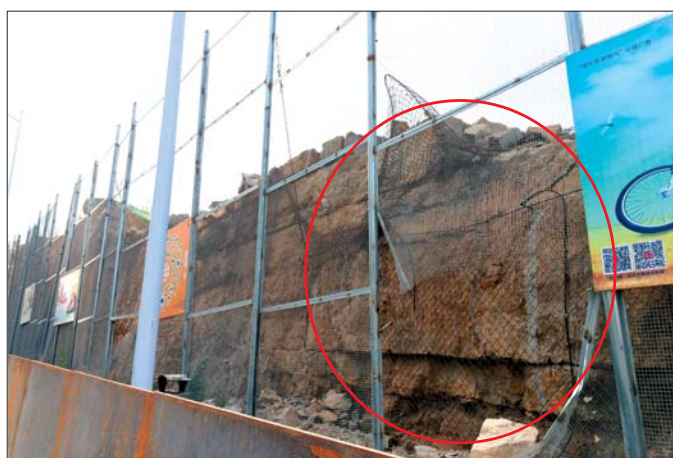
工地所做的防护栏,部分已有损坏。
